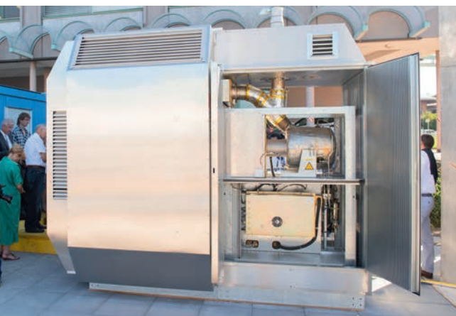
Das Methanol-Minikraftwerk «Econimo» liefert Strom (25 kW) und Wärme zum Heizen (70 kW) oder kaltes Wasser zum Kühlen (40 kW).
