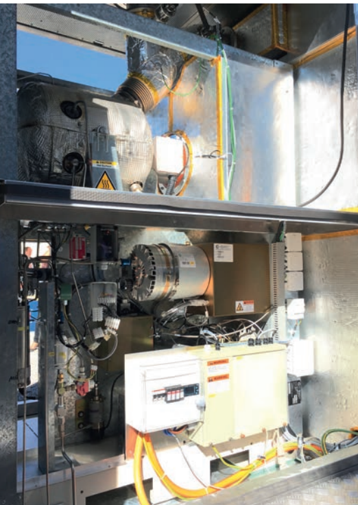
Das erste Econimo-Aggregat für die WWZ wird mit Methanol-Mikrogasturbine (oben) und Generator betrieben.
